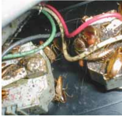
食器洗浄機の内部
